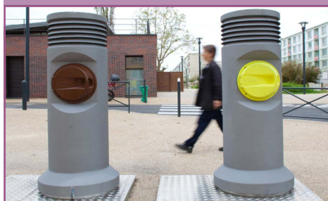
Gestion souterraine des déchets
