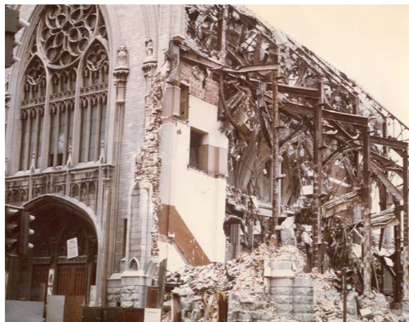
Démolition de l'église Sainte-Catherine-d'Alexandrie, 1972. Source : Fonds Claude Waters, Écomusée du fier monde.
