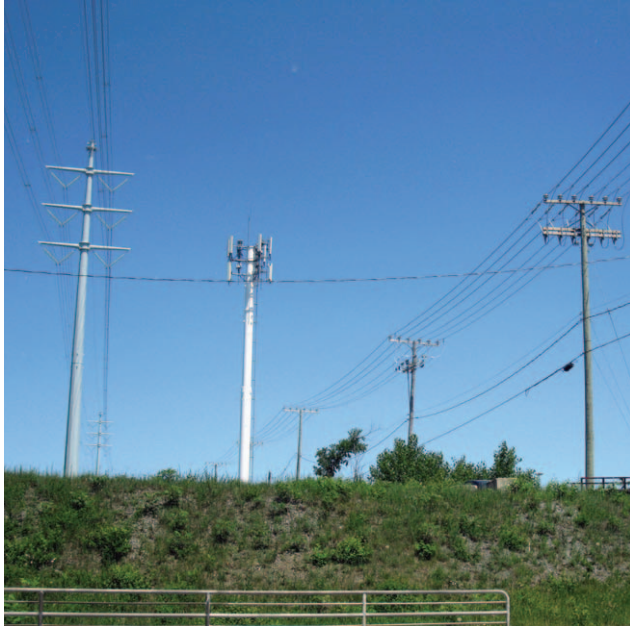
Ligne à haute tension, antenne et ligne de distribution
