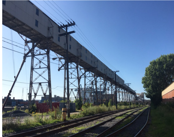
94. Structures linéaires et aériennes des convoyeurs
