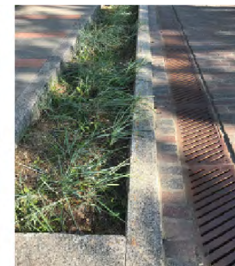
Caniveau intégré à la conception de voies piétonnes
