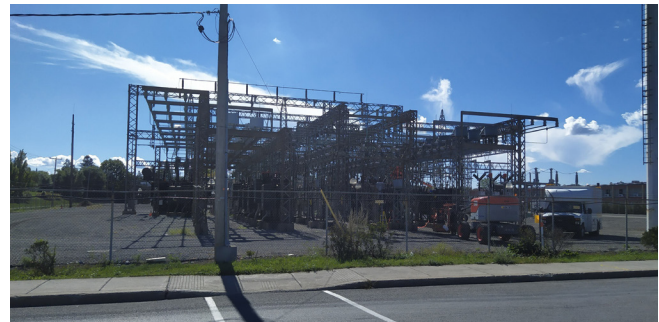
Le poste de transformation électrique. Source : AECOM
