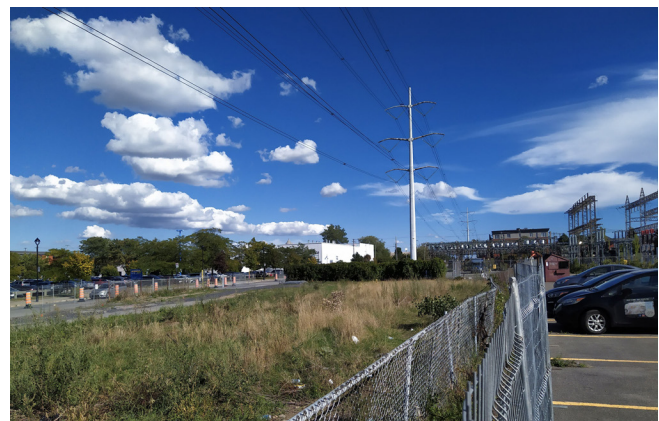
La servitude associée à la ligne de transport à haute tension d'Hydro-Québec. Source : AECOM
