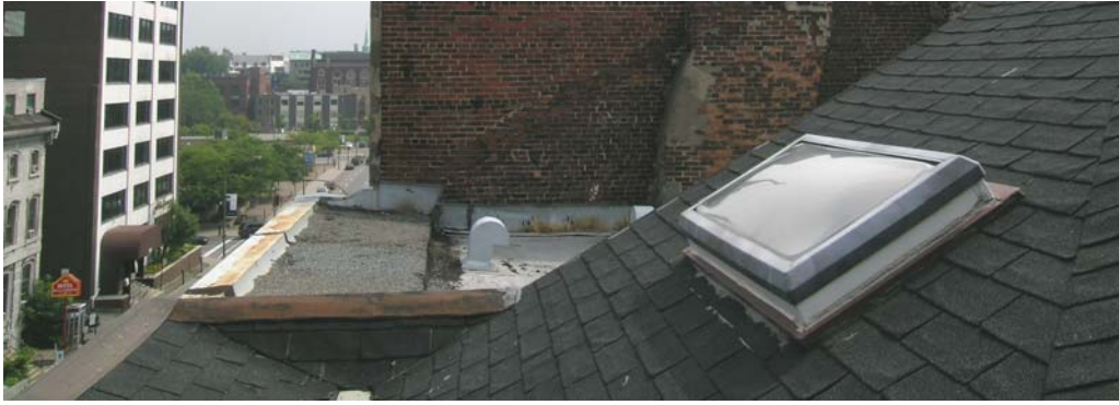
Bardeaux d'asphalte montrant des coins qui retroussent (2004).
