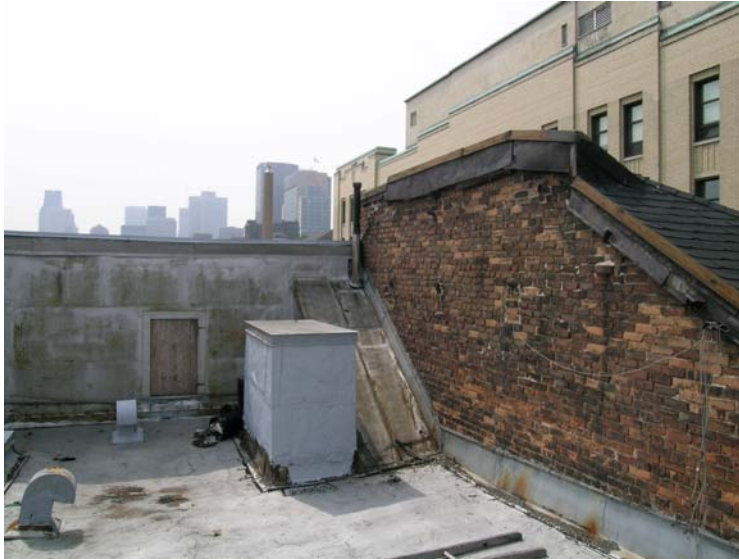
Le toit du 1044 Saint-Denis dont le versant a été éliminé (2004).
