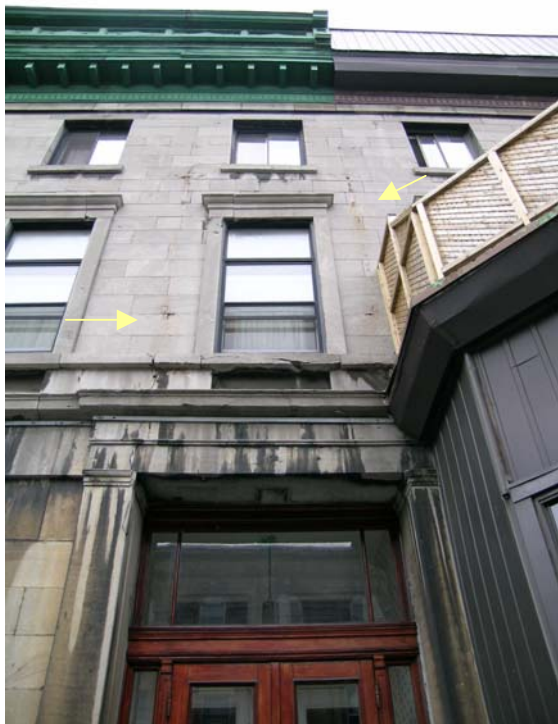
Traces des balcons de métal (2004).
