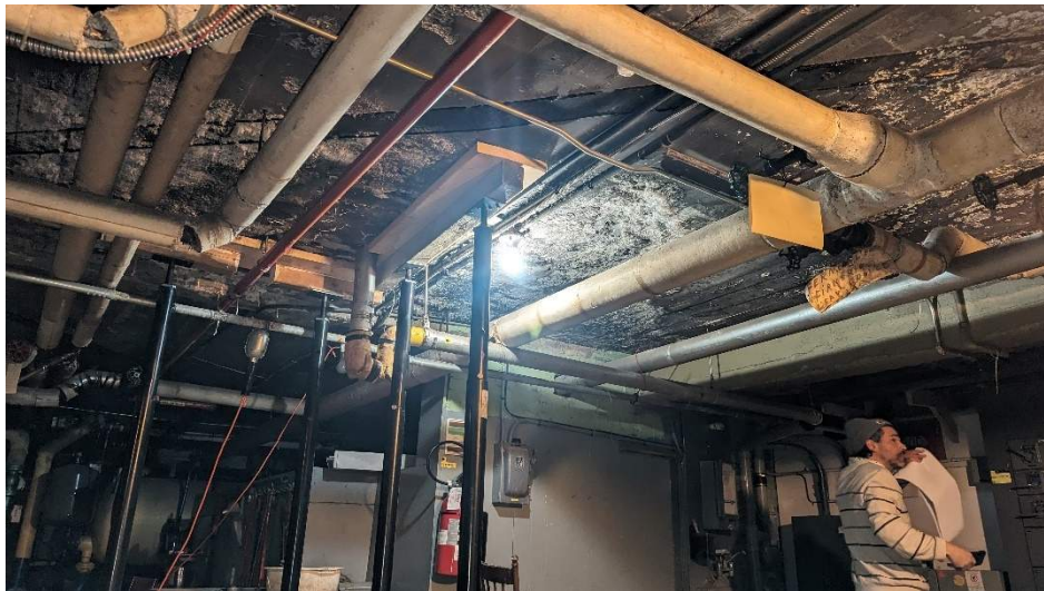
Photo 5: Délamination, efflorescence et étais sous le garage
