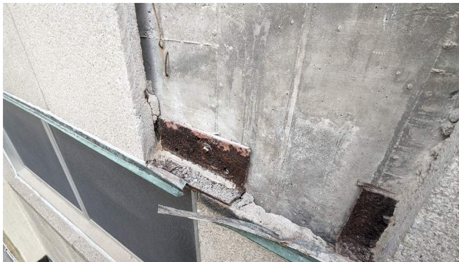
Photo 20 : Linteaux structuraux corrodés
