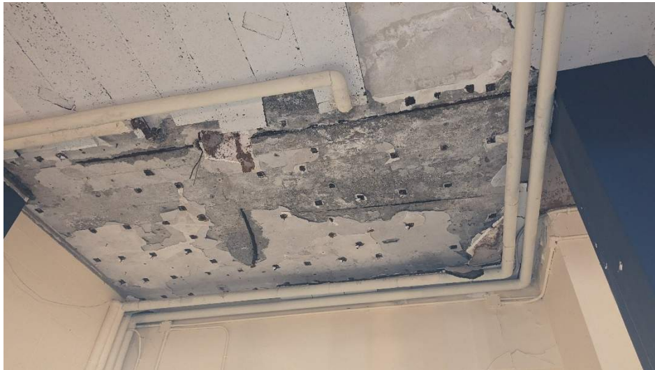
Photo 4 : Endommagement à l'intrados du parvis d'origine
