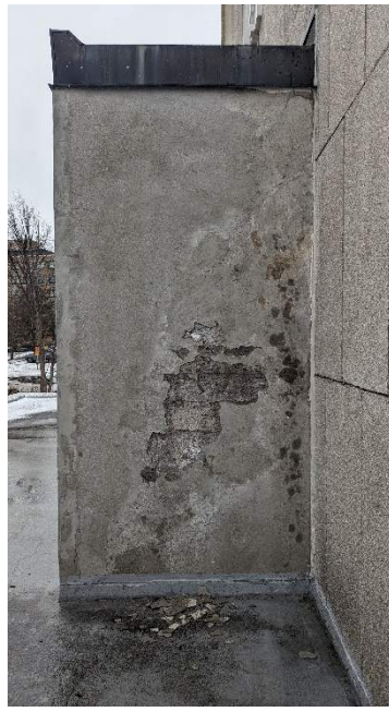
Photo 16: Murs à l'entrée (Délamination du crépis)
