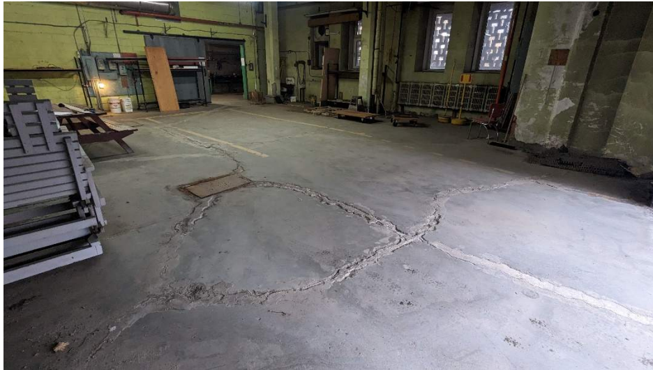
Photo 6 : Fissuration à l'extrados de la dalle du garage
