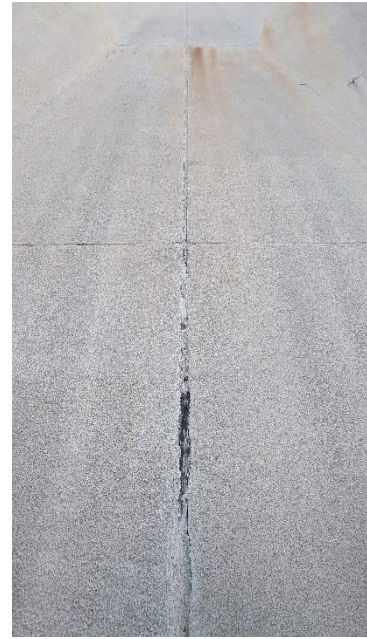
Photo 14 : Conditions au joint des panneaux
