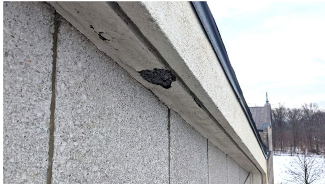
Photo 9: Écaillage de la membrane en acrylique
