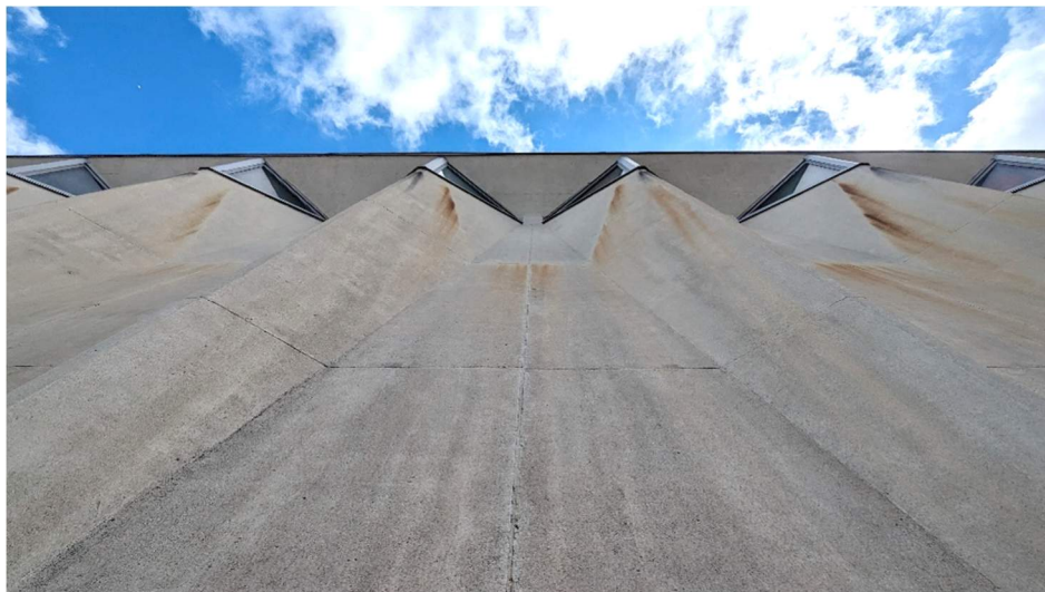
Photo 8: Condition typique des faces exposées des panneaux de béton
