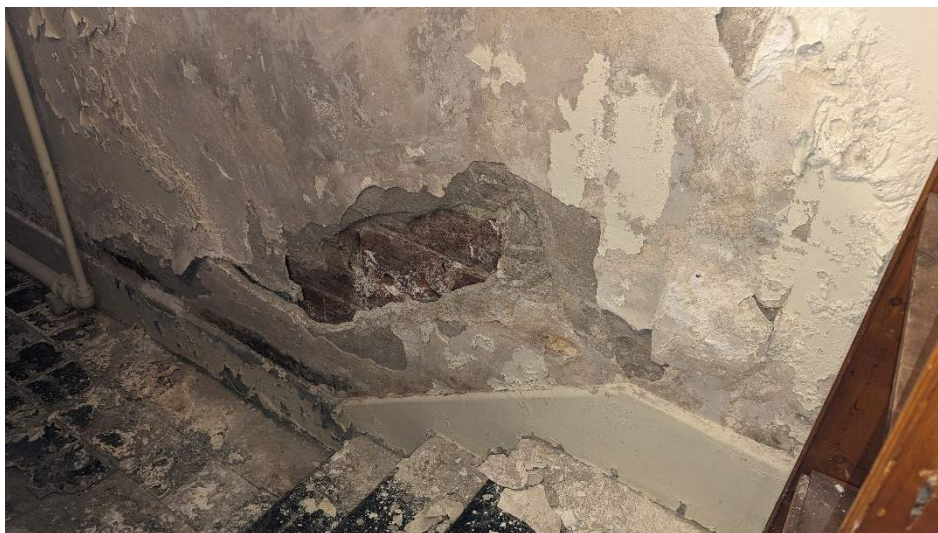
Photo 3: Infiltration d'eau - Ancienne sacristie (cloître)
