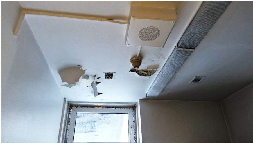
Photo 8 : Traces d'infiltration d'eau - Intrados 2ie étage (cuisine-côté sud)
