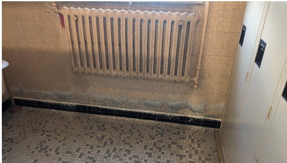
Photo 4 : Efflorescence à la base des murs de blocs (1 de 2)
