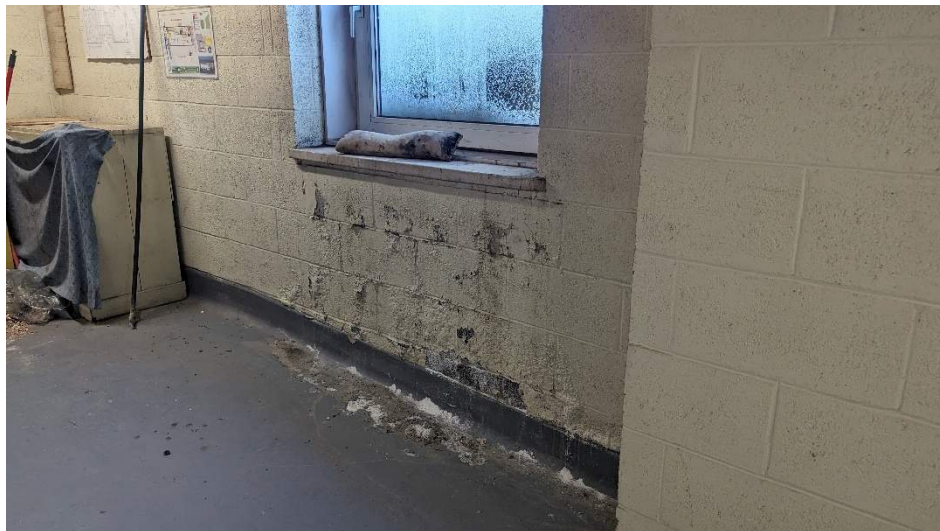
Photo 5 : Infiltration d'eau et efflorescence apparente (2 de 2)
