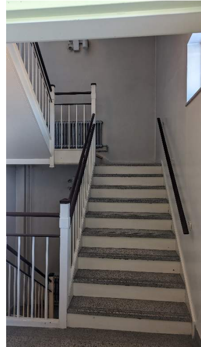
Photo 11 : Escalier d'issue typique
