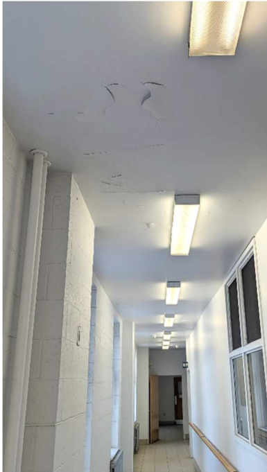
Photo 9 : Traces d'infiltration d'eau - Intrados 2ie étage (cuisine-côté nord)
