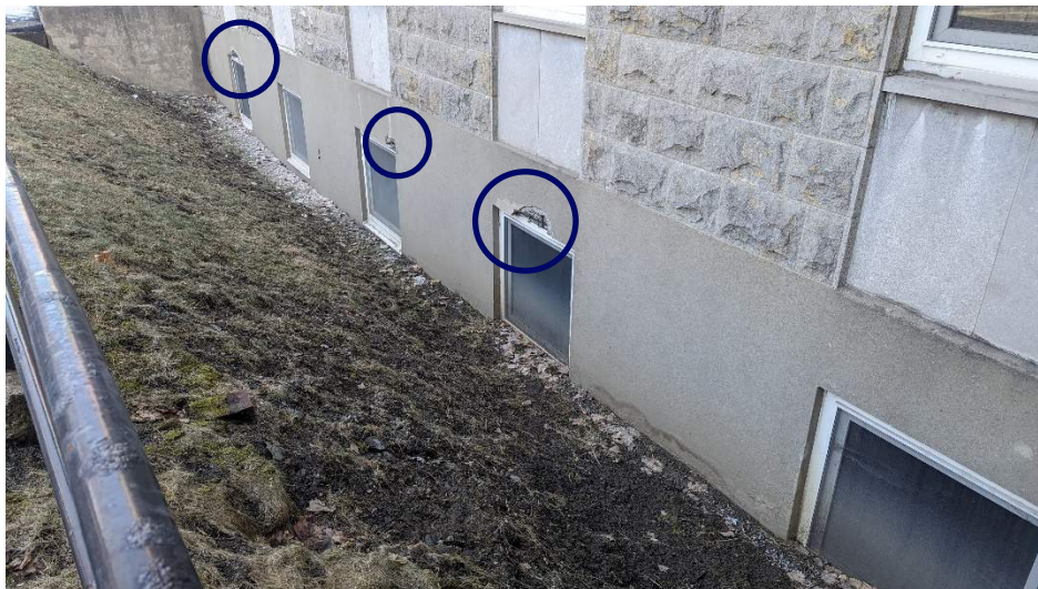
Photo 3 :Endommagement du mur de fondation partie supérieur (côté nord)
