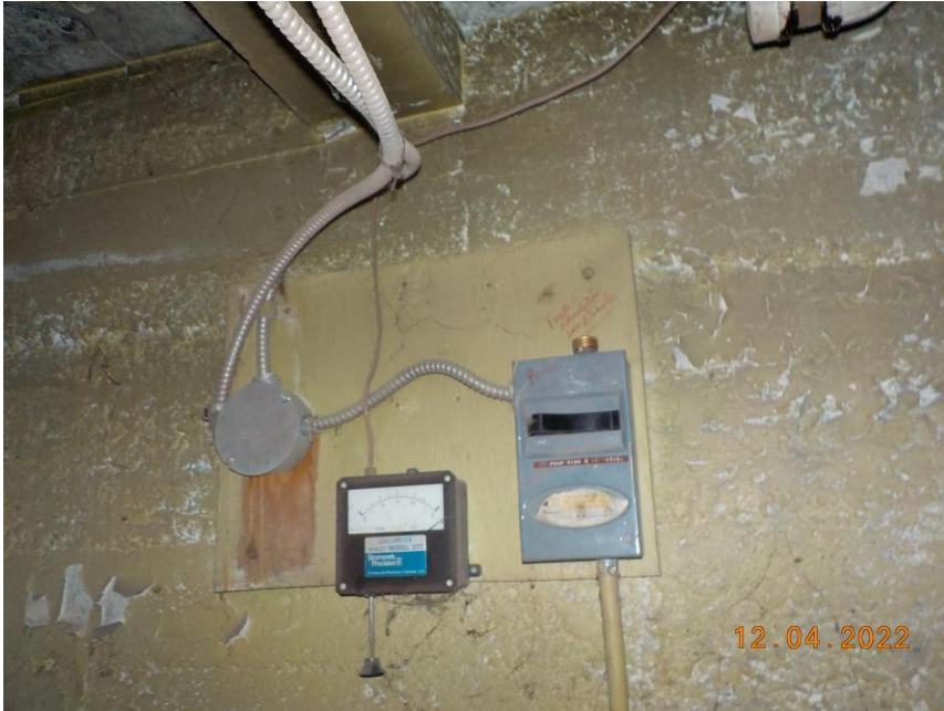
Photo 5 Vue de la jauge possiblement associée aux réservoirs souterrains abandonnés à l'extérieur
