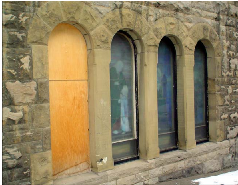
FIG 64 : Un des vitraux de la chapelle a été placardé en raison de son mauvais état (C. Boucher, 2006)
