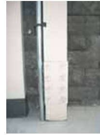
Figure 34 : REF 2006-04-06 LB 177. Détail de la structure d'acier érigée le long du mur de pierre.
