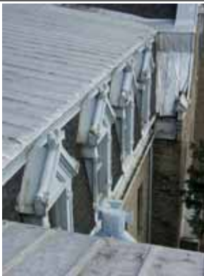
Figure 30 : REF 2006-04-06 LB 128. Profil des lucarnes, avec la toiture à baguettes au-dessus; l'ardoise a été remplacée par du bardeau d'asphalte.
