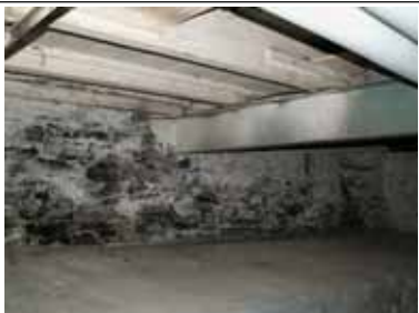
Figure 35 : REF 2006-04-06 YN 073. Vue générale. Noter la présence de pierre pour les murs extérieurs, de béton, de bois et de métal.
