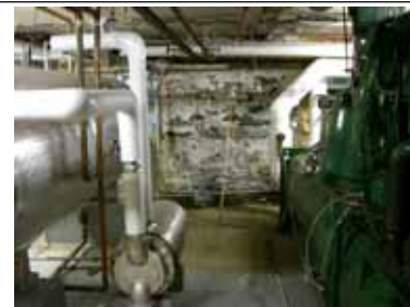
Figure 37 : REF 2006-04-06 LB 016. Vue générale de la salle de chauffe.
