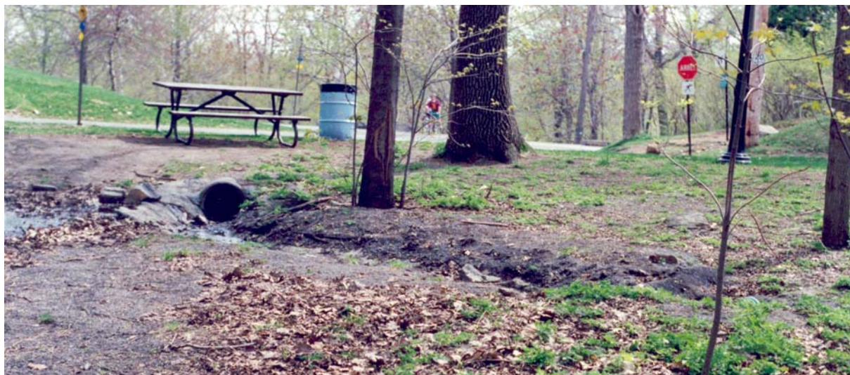
Le secteur du muret-digue avant les travaux, remarquer le tuyau sous les racines d'arbres
