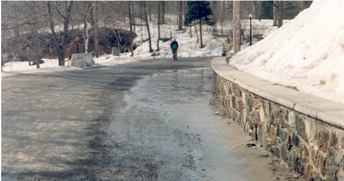
Avant la construction du muret-digue, débordement d'égout pluvial, érosion du chemin Olmsted derrière le chalet, écoulement des eaux vers le belvédère Kondiaronk et le marécage
