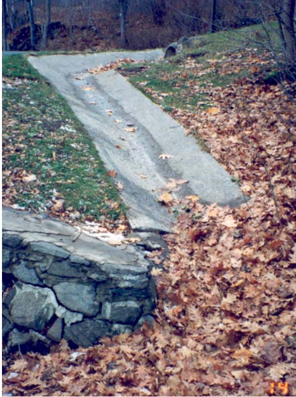
Caniveau en béton qui se déversait les eaux sous le pont, avant les travaux
