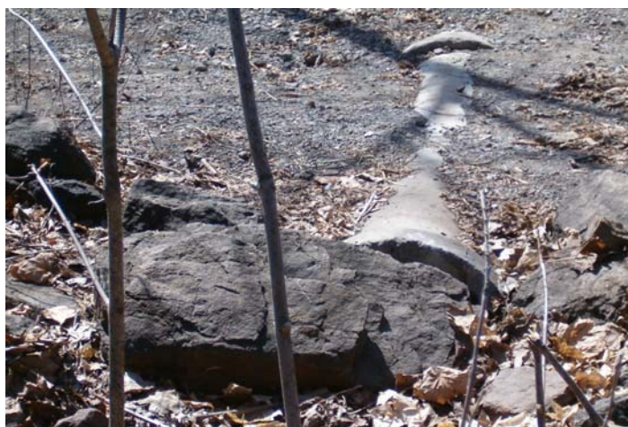
Une roche poussée par des vandales devant un tuyau a fini par obstruer le cours d'eau et entraîner l'érosion du sentier
