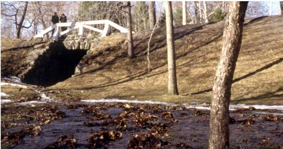
Eaux dirigées précédemment sous le pont sous le chemin Olmsted
