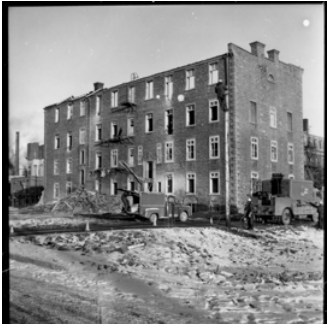
En cours de démolition Source : Archives de la Ville de Montréal U-98-4
