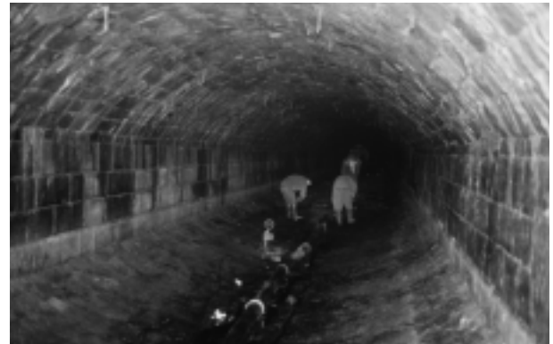
24.AP.3 et BjFj-004 Le collecteur William a été construit en 1832 pour canaliser la rivière Saint-Pierre ou Petite Rivière. Le collecteur est imbriqué au marché Sainte-Anne. Cet imposant ouvrage de maçonnerie de pierre est conservé intégralement sous la place d'Youville, il a été désaffecté en 1990.
