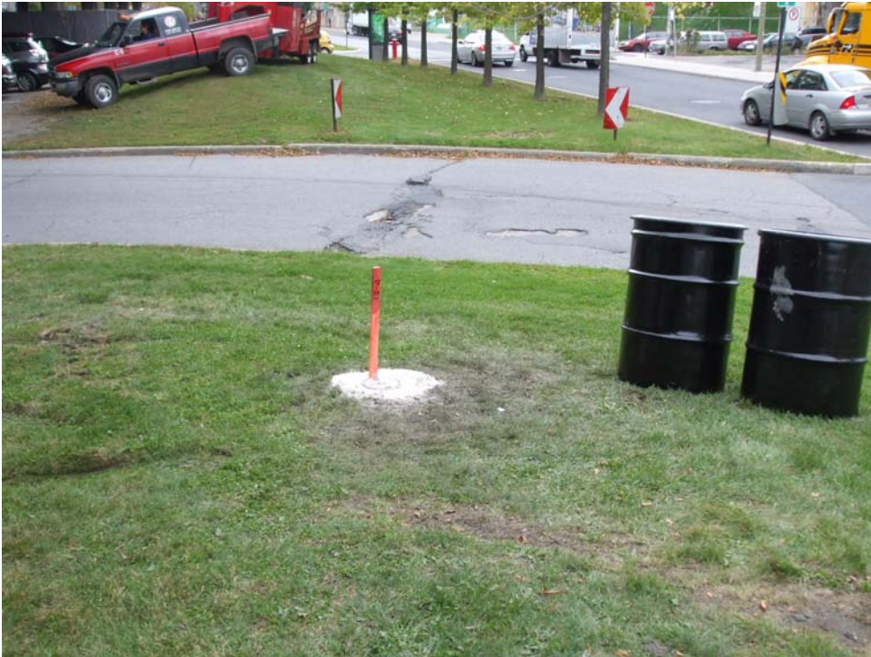
Photo 11 : Vue de l'état final d'un puits d'observation avec récupération des rejets de tarière (sol) et disposés par barils.
