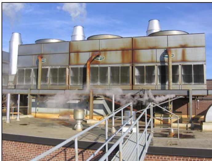
Tours de refroidissement
