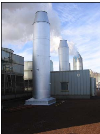
Cheminées de chaudière
