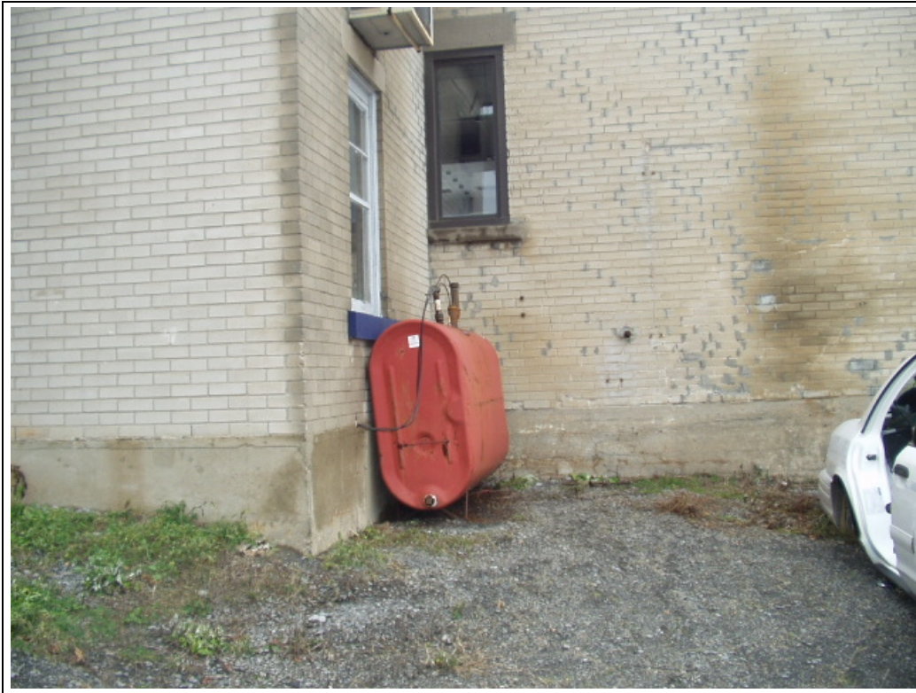
Photo No 3 – Vue du réservoir hors-sol R9. Le réservoir souterrain R7 était situé à proximité de R9.
