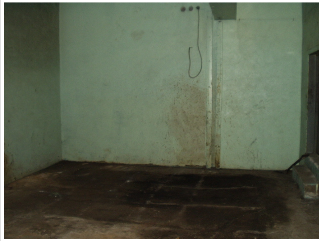
Photo No 5 – Localisation du réservoir hors-sol R8 démantelé qui était situé dans le sous-sol du bâtiment B. On note la présence de taches d’huile sur la dalle de béton.
