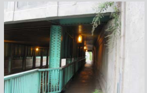
Le passage inférieur de l'avenue du Parc, au niveau de l'avenue Van Horne, est peu attrayant et est source d'inconfort pour les piétons.
