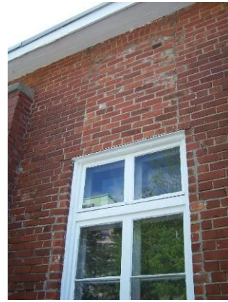
277 : Traces d'une ouverture partiellement obstruée. Source : MBrodeur consultant inc. Photo Éric St-Louis Saint-Louis.
