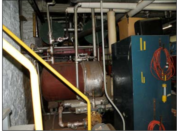
50. Autre vue des équipements mécaniques.
