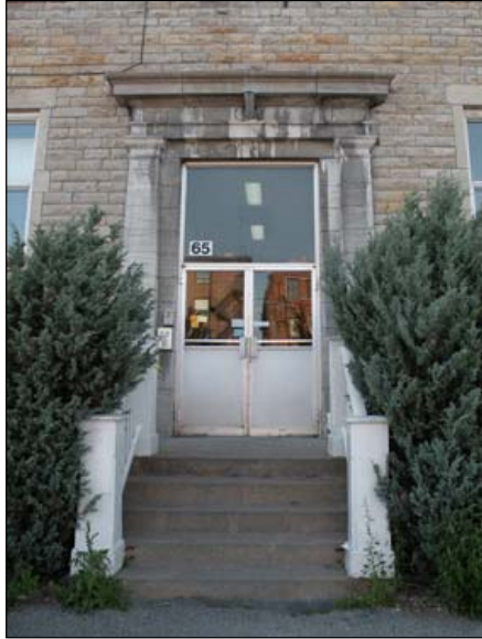
39. Portail de l'entrée principale, avec pilastres, entablement et corniche en pierre de taille.
