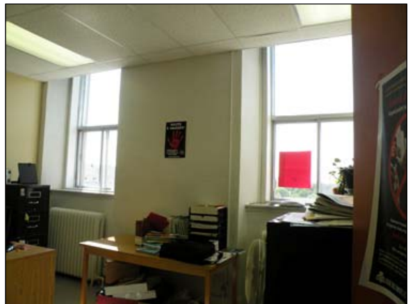
58. Dans plusieurs locaux, un plafond suspendu a été installé et cache la partie supérieure des fenêtres.
