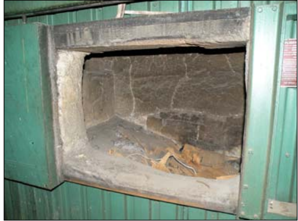
44. Au sous-sol se trouve un incinérateur.
