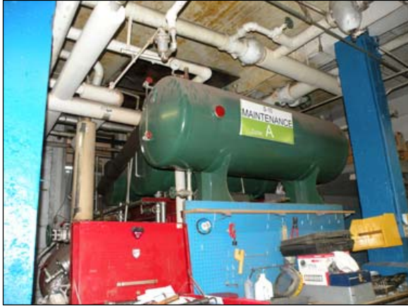
49. Salle d'équipement mécanique située au sous-sol, à l'arrière du bâtiment.
