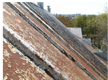
Figure 75 : REF 2005-05-13 LB 103 État de la toiture de tôle – versant ouest
