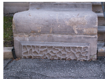
Figure 83 : REF 2005-05-06 LB-JR 126 Pierre vermiculée de l’escalier de l’entrée principale
