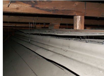
Figure 57 : REF 2005-05-13 LB 138 Détail de la toiture de tôle et d'ardoise d'origine dans l'entretroit du couvent
