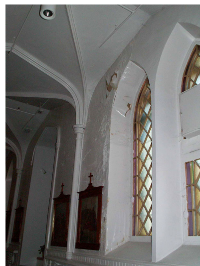
Figure 68 : REF 2005-05-13 LB 054 Exemples de dommages causés par l'eau
