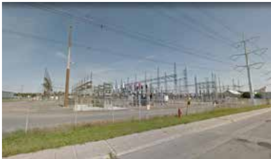
Poste d'Hydro-Québec, rue Notre-Dame Est
