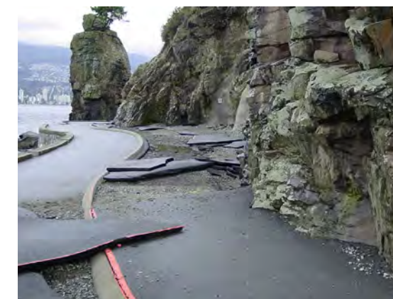
24- Dommages causés au seawall suite à la tempête de 2006
