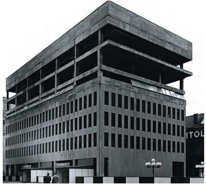
Ajout de 3 étages au 4 Place Ville Marie, tiré de France Vanlaethem et al. (2012), Place Ville Marie. L'immeuble phare de Montréal , Montréal, Éditions Québec Amérique.
