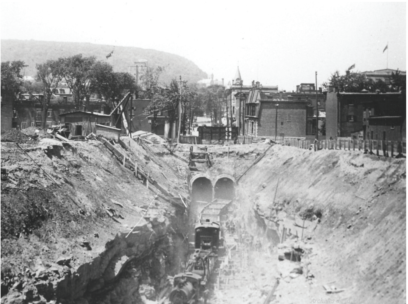
Construction du tunnel du CN sous l'avenue McGill College, Archives de la Ville de Montréal, 010_BM42-G1036.
