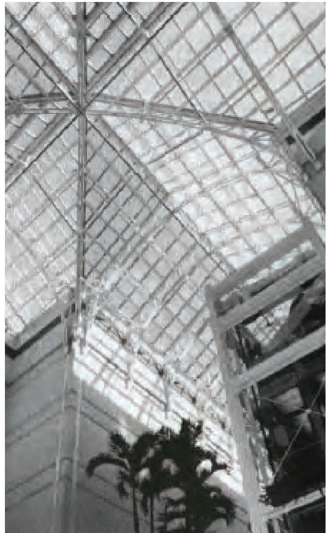
Détail de la verrière, Le Centre Eaton de Montréal (1990), « Le Centre Eaton de Montréal », ARQ Architecture-Québec , no-64, novembre-décembre, p. 12.
