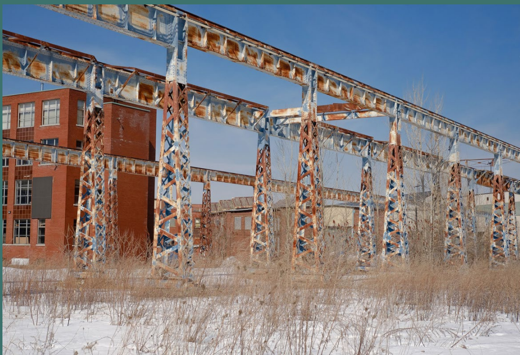
Figure 2 - Ponts roulants de la Dominion Bridge depuis le boulevard Saint-Joseph. Source : Photo prise lors de la visite de terrain le 17 mars 2022
